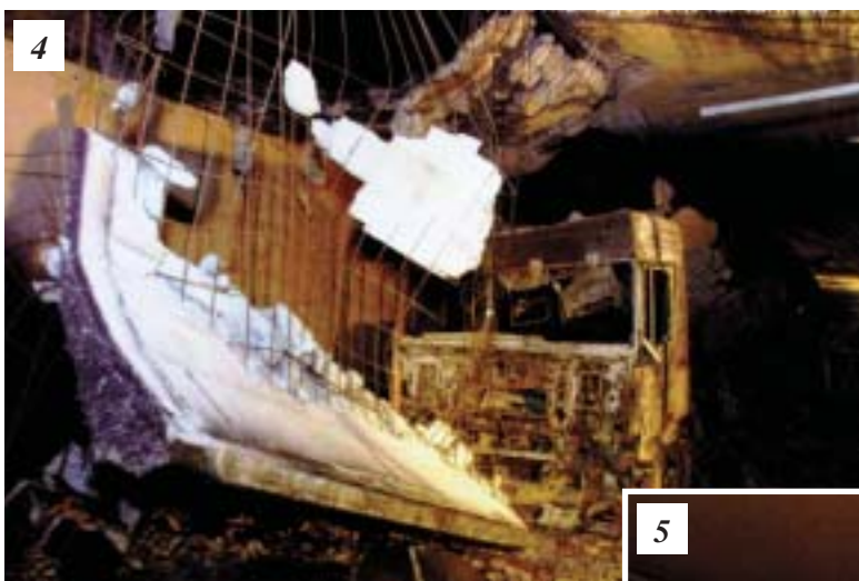
4 - Traforo del Gottardo. Danni strutturali (Foto DPA del 31 ottobre 2001).
