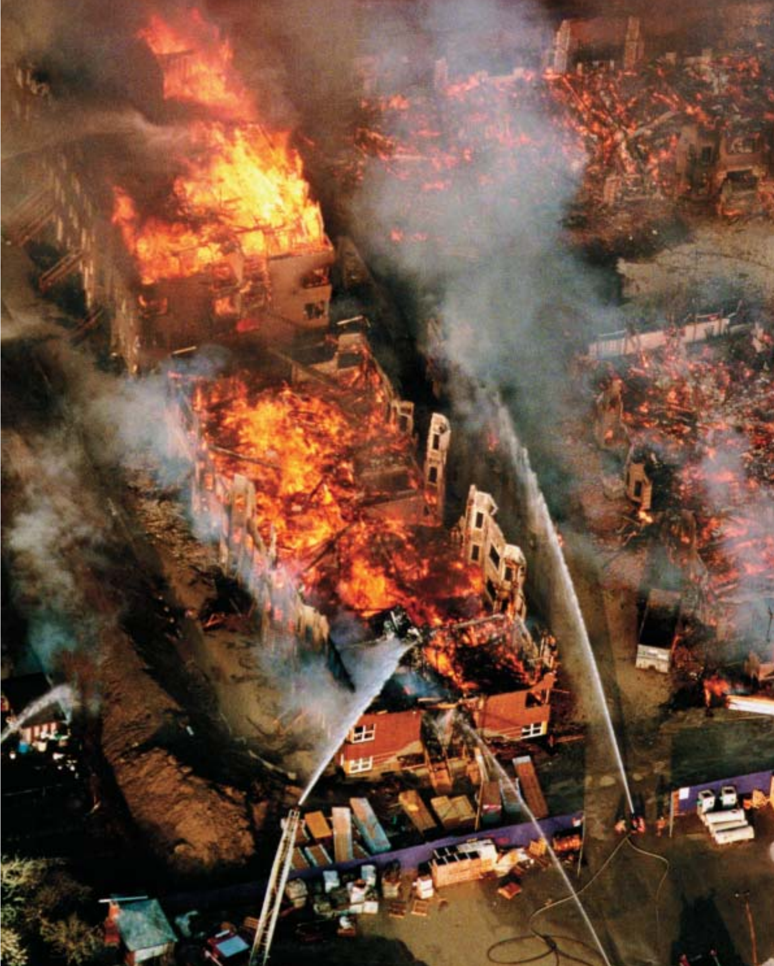
Incendio in un complesso residenziale in costruzione a Toronto (Canada) nel maggio del 2001 durante l'impermeabilizzazione del tetto a caldo (con cannello a gas propano). Danno stimato in 6,5 milioni di dollari (Foto Toronto Star).
